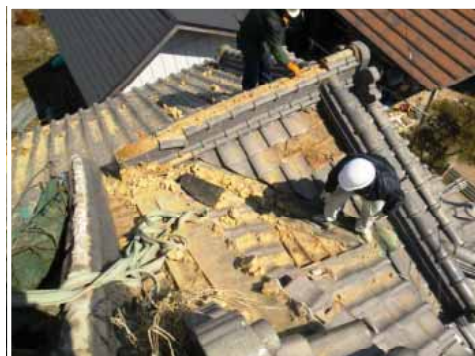
棟瓦が屋根を直撃
