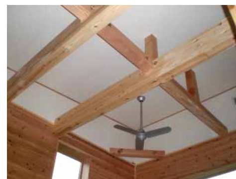
吹抜けのフロアファン
